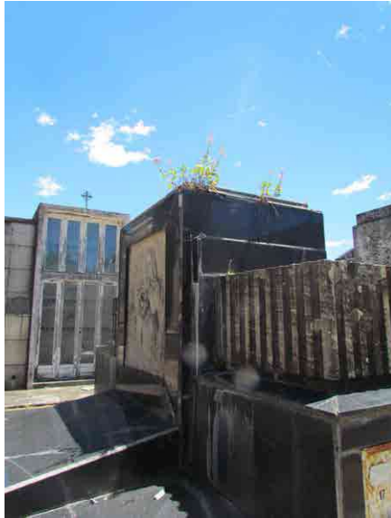
Foto 1. Desprendimiento de pieza granítica
