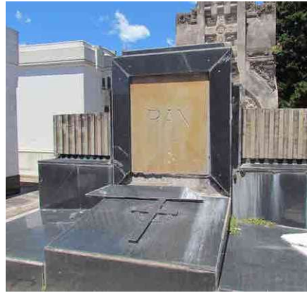
Foto 4 – manchas de sales adheridas al granito
