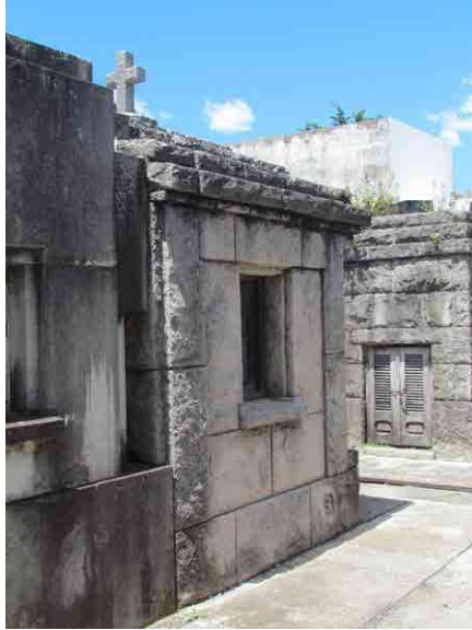
Foto 1 – suciedad en frente de piedra
