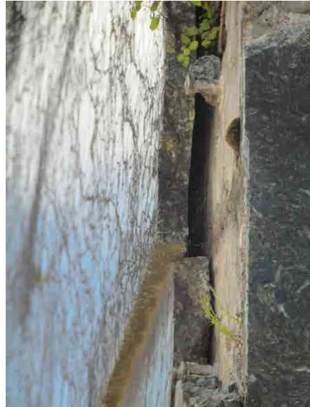
Foto 2. Caída de material - desprendimiento
